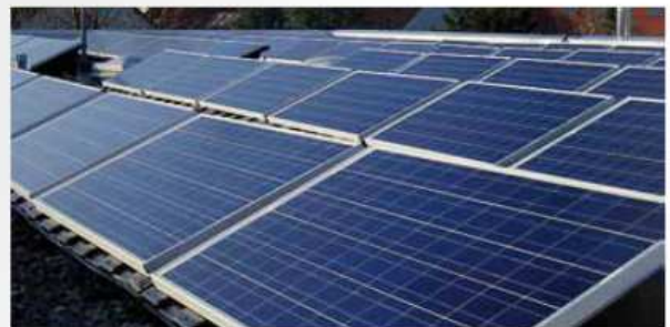
PV-Anlage Gebrüder-Grimm-Schule, Ingelheim
