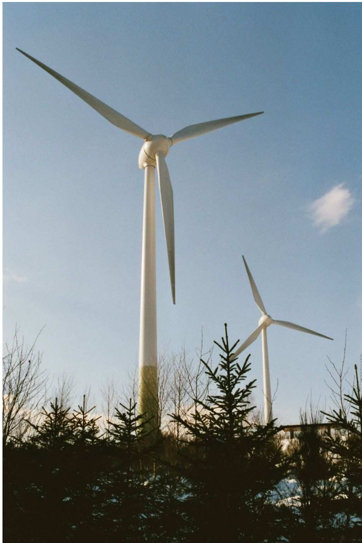
Die drei Windräder auf dem Kandrich haben seit Errichtung der ersten Anlage (links im Bild) 100 Millionen Kilowattstunden schadstofffreien Strom geliefert. Bild: GEDEA-Ingelheim.
