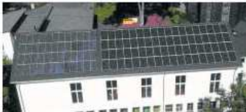
Die Photovoltaikanlage auf dem evangelischen Gemeindehaus produziert seit Ende Juni Strom.
